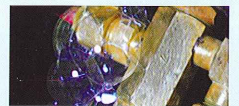
発泡液で漏えいを確認
