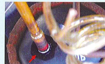
油濡れやしみて漏えいを確認
